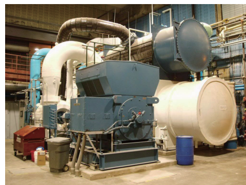
10吨制冷量制冷机
